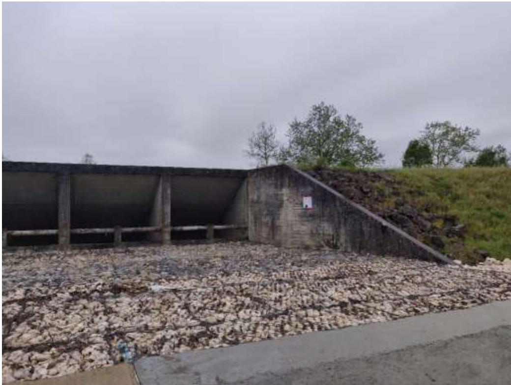
Placa permanente de cofinanciamento do POSEUR no muro do encontro da estrutura de dissipação de energia do descarregador ECC 1
