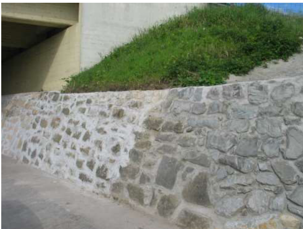
Estrutura de dissipação de energia do descarregador ECC 3 Obra concluída – Pormenor da reabilitação do muro do talude da A1
