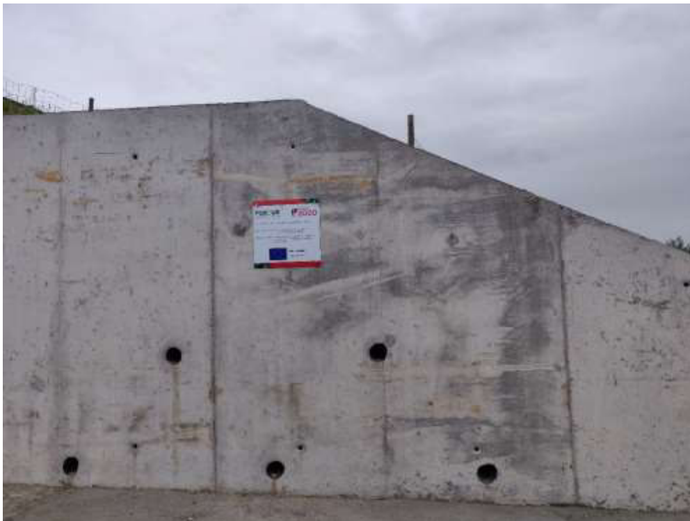
Placa permanente de cofinanciamento do POSEUR no muro de suporte da estrutura de dissipação de energia do descarregador ECC 3
