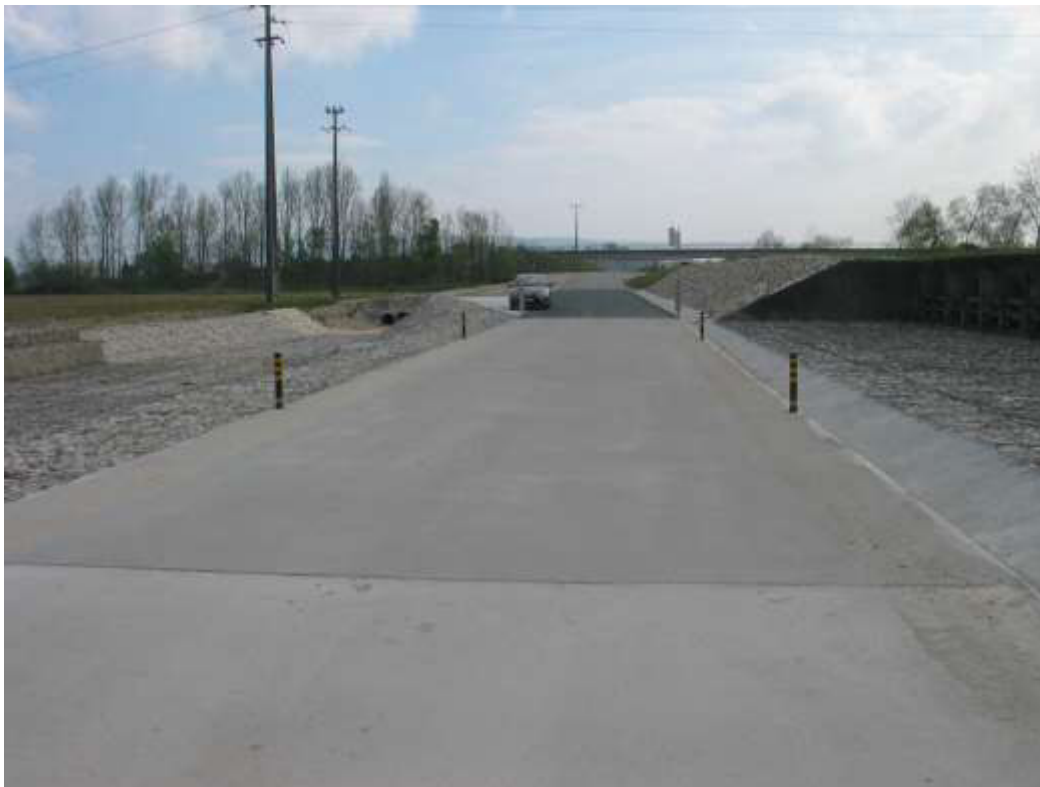
Estrutura de dissipação de energia do descarregador ECC 3 Obra concluída com a pavimentação da estrada
