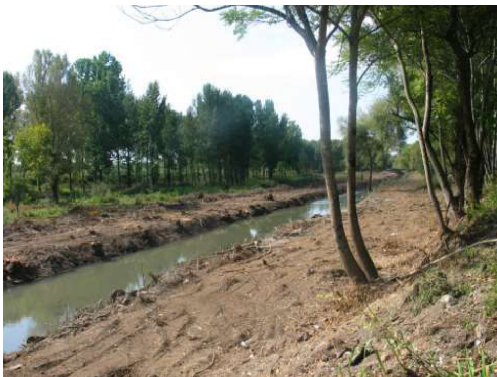
Limpeza de vegetação no troço entre o viaduto da A1 e a travessia de s. João do Campo - Vista para jusante
