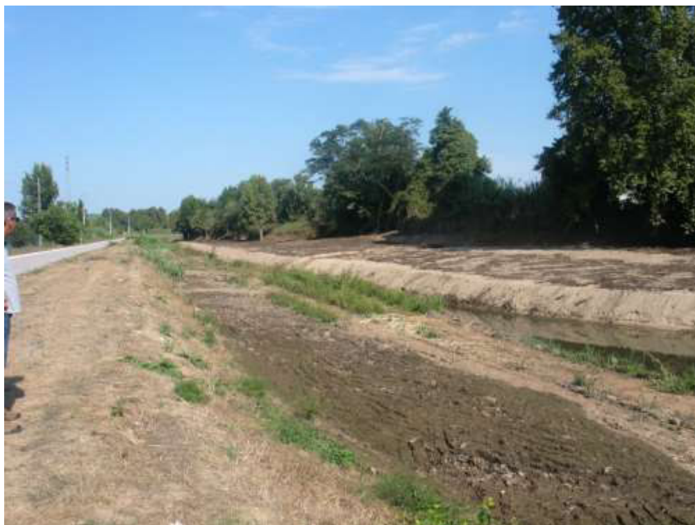
Aterro da plataforma do leito maior e desassoreamento do leito menor entre a EN 111 e a travessia do Loreto (concluídos) – Vista para jusante
