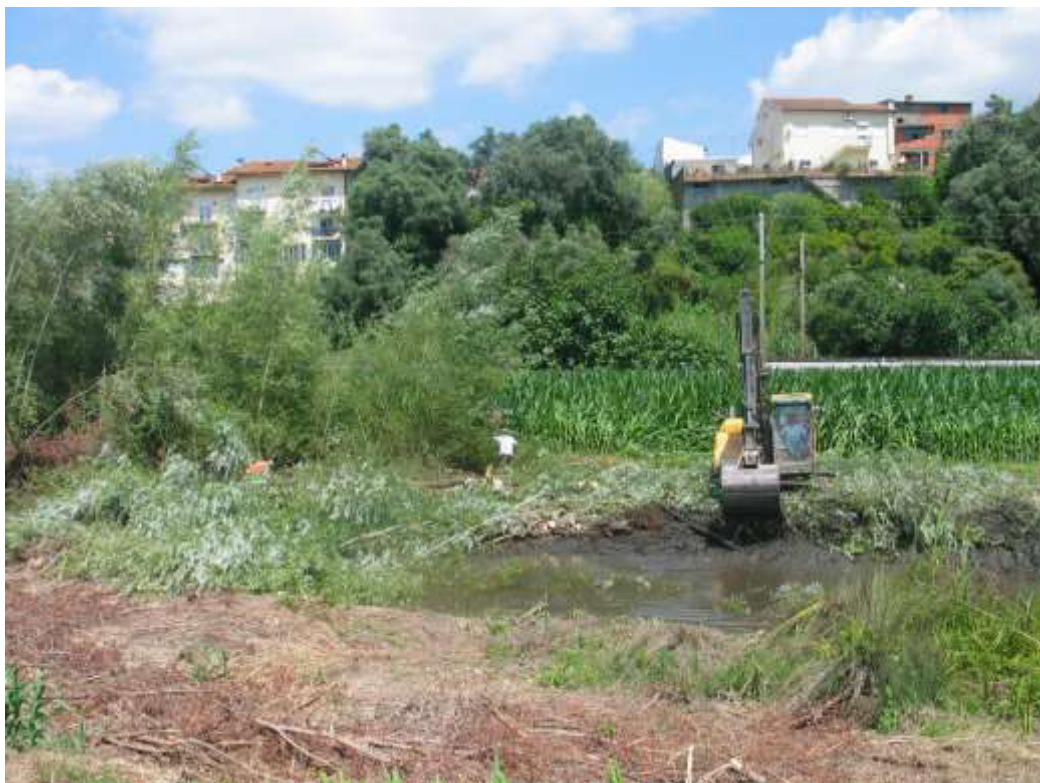
Limpeza de vegetação e desassoreamento do leito menor, entre a travessia da Pedrulha e a passagem de nível
