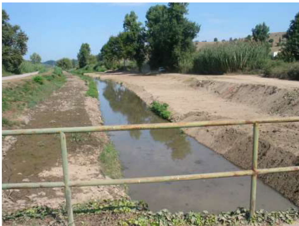
Aterro da plataforma do leito maior a jusante da travessia do Loreto (concluído) – Vista para jusante
