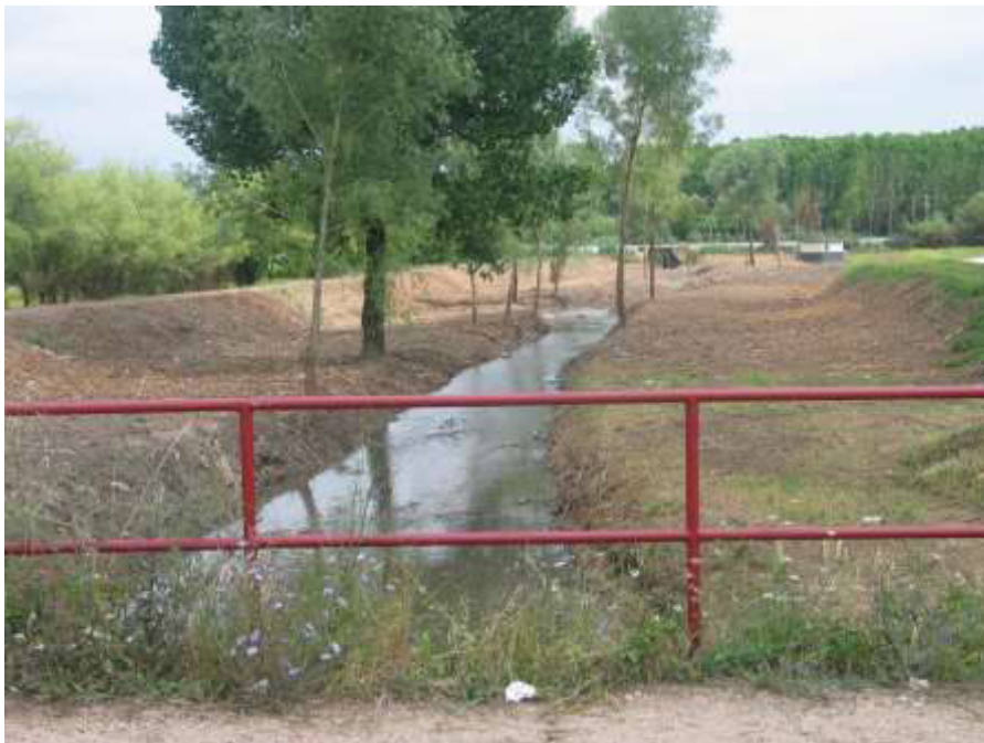
Limpeza de vegetação e desassoreamento do leito menor concluídos, entre o aqueduto da ribeira de Eiras e a travessia da Adémia
