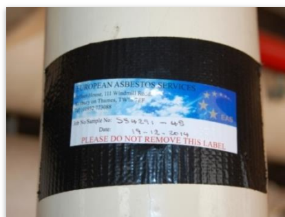
Tubo de amianto marcado. Fonte: UEFG
