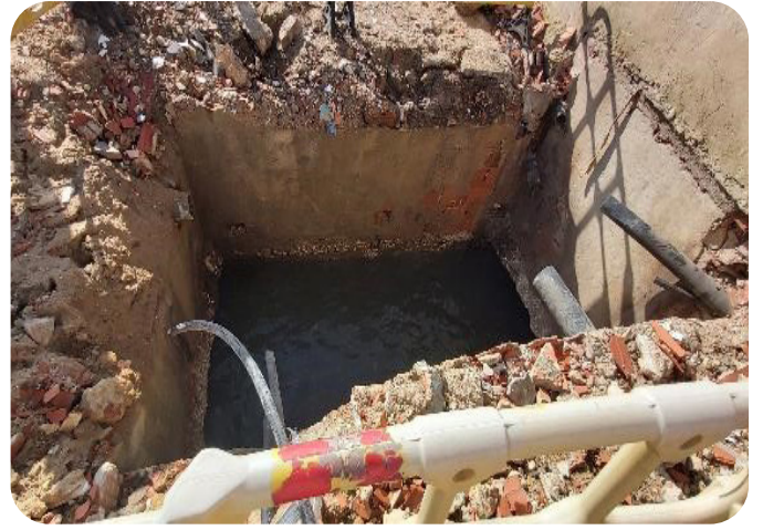
Descargas ilegais no troço manilhado
