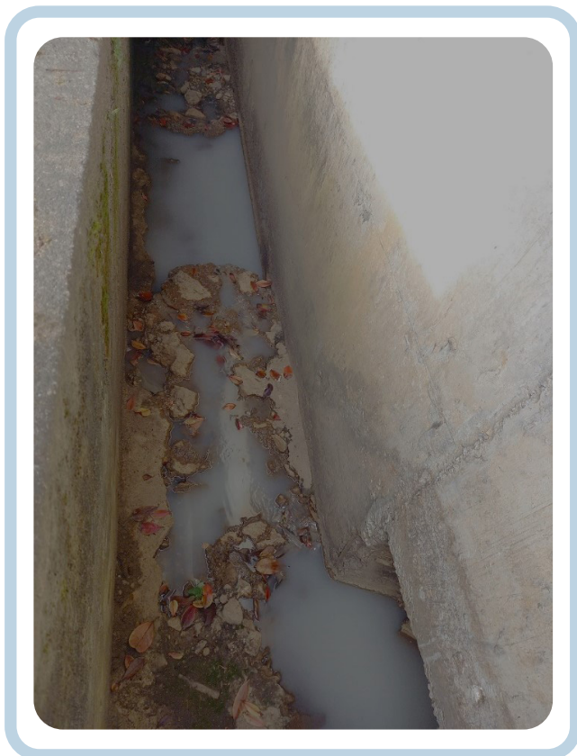
Linha de água visualmente alterada por uma rejeição de águas residuais
